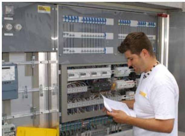
Diego Balduzzi (Bauleitender Monteur) bei der Schlusskontrolle der Steuerung (Mini-SPS) für die Beleuchtung von 2 Kreiseln, Busbahnhof und Brunnen
