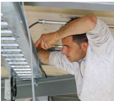
Dario Mergola (4. Lehrjahr) beim Anschliessen der LED-Zuleitungs- kabel im Dach des Busbahnhofs
