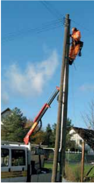
Freileitungsbau auf einer Telefonstange
