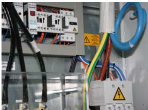
Hauptschalter-Schrank mit Kabel 5 x 95 mm 2
